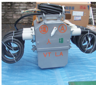
設置した機器
